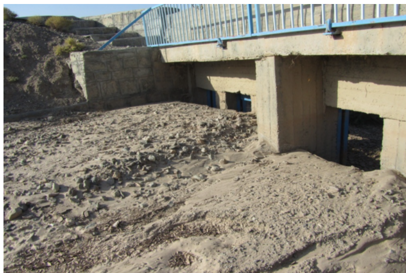
شکل ۳. رسوبگذاری شدید و عدم رعایت شیب طولی صحیح در کانال انتقال
