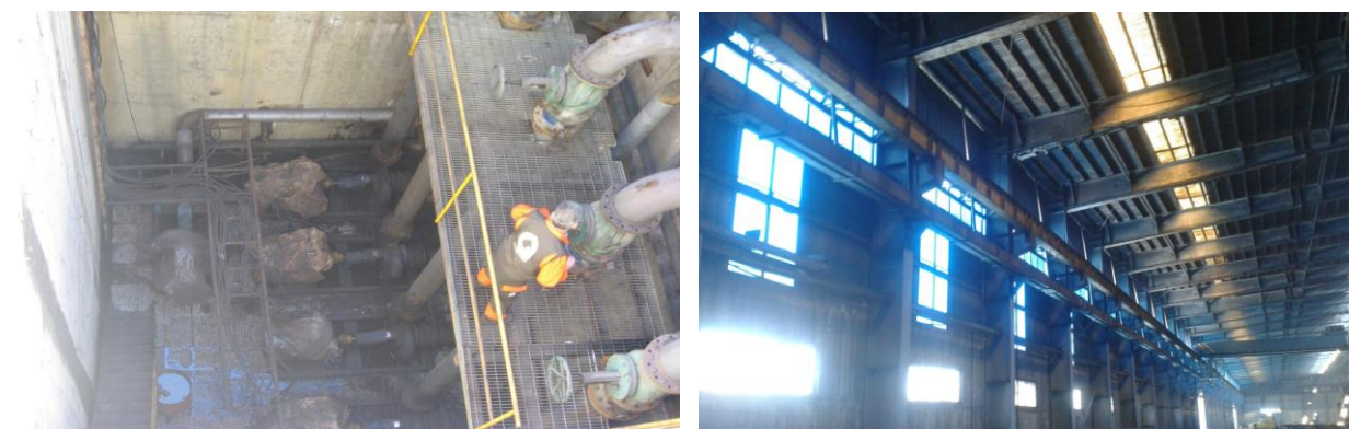
شکل 2: کانال طولی جمع‌آوری آب باران در زیر سقف (راست)، ایستگاه پمپاژ آب از استخرهای ذخیره به داخل سیستم (چپ)
