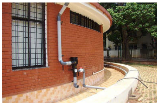
شکل (۷) لوله‌کشی و انتقال آب باران از روی پشت‌بام
